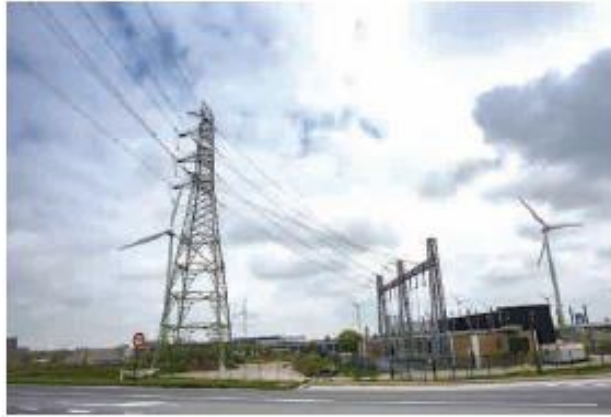
Figure 136 : Exemple de poste de transition (source : Note technologique, Elia 2019)
