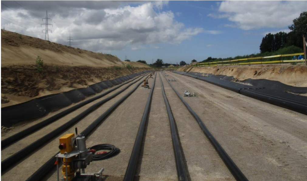
Figure 53 : Exemple de zone de chantier pour une pose souterraine ici de 4 ternes 380 kV- 4GW sur la liaison Stevin. Cette liaison comprend 4 circuits (12 câbles) alors que la Boucle du Hainaut devrait en compter 6 (18 câbles) (source : Elia
