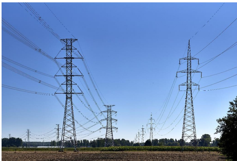
Figure 12 : Pylônes portant une ligne de 380 kV compact (à gauche) et de 150 kV (à droite)
