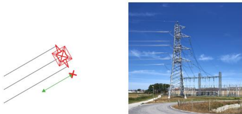
Figure 11 : Pylône d'extrémité (source : Elia)
