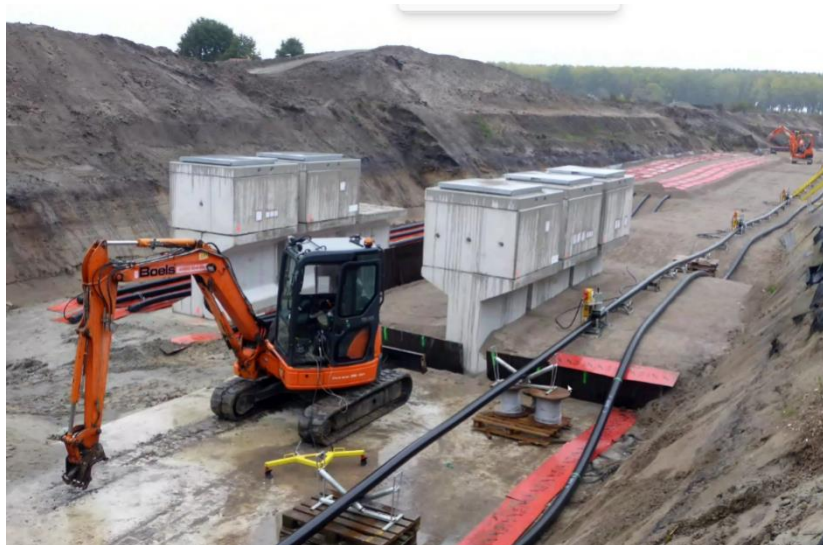
Figure 54 : Exemple d'installation de puits d'inspections. Chaque puit mesure environ 2,8m x 2m sur 1,4 m de haut dont +/- 50 cm seront visibles hors sol (source : Elia)
